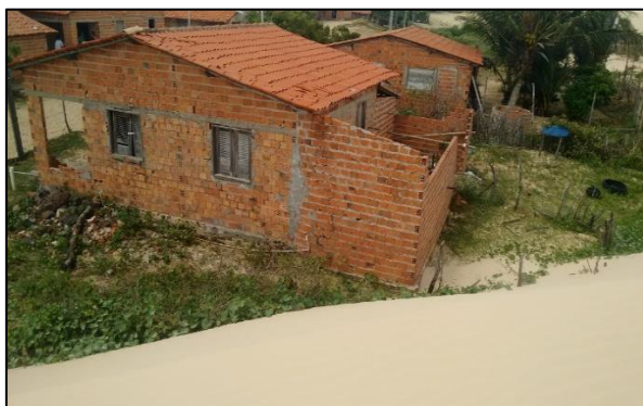
Figura 10: Residência 2 já comprometida pelo avanço da duna
